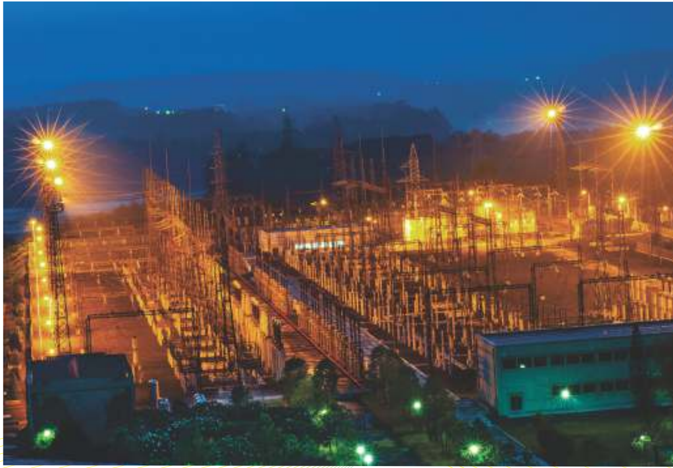
TRẠM PHÁT ĐIỆN TRỊ AN ẢNH: TRẦN HỮU CƯỜNG
